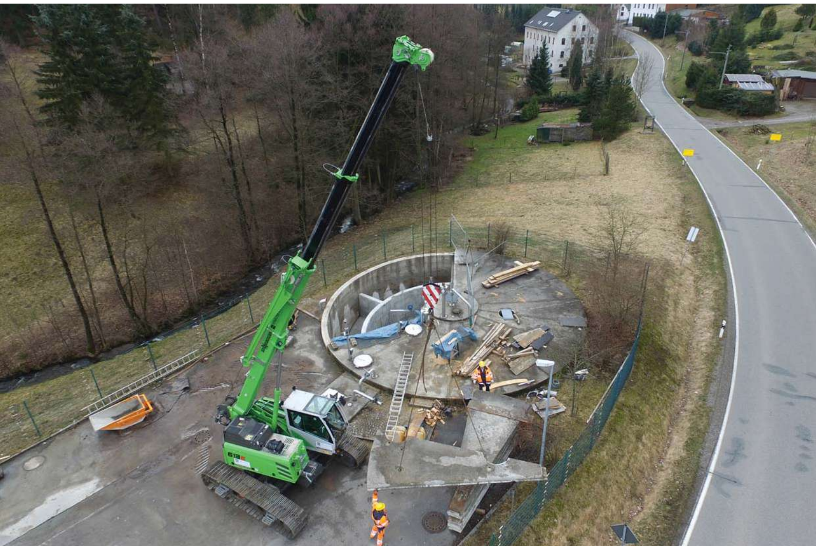
Le châssis sur chenilles SENNEBOGEN 613 E déplace et lève des charges lors de la construction d'une station d'épuration provisoire en Allemagne.
